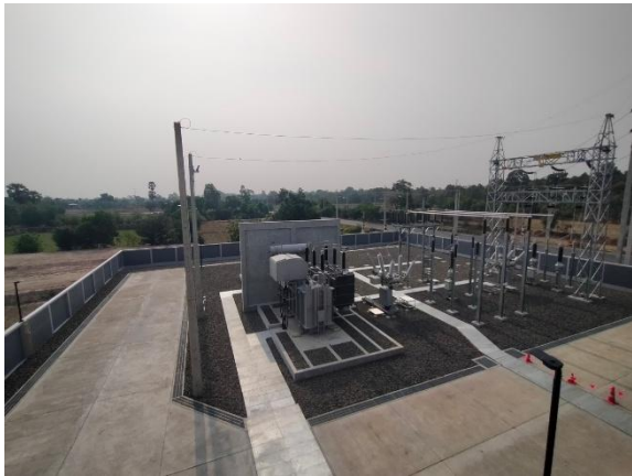
สถานีไฟฟ้าตุนบุรี
