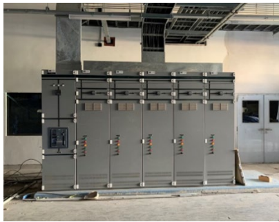
งานติดตั้งระบบตู้ไฟฟ้าแรงดันต่ำ (400โวลท์)
